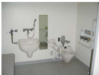
車椅子対応多目的トイレ
